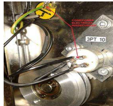
Fig. 3: Conexiones eléctricas mal realizadas con peligro de cortocircuito.
